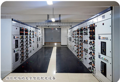
项目现场的齐全智能配电设备
